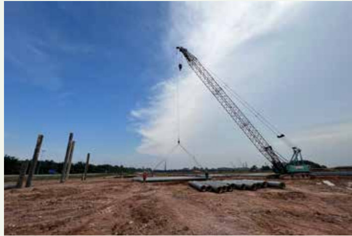
秦淮数据中心项目开工照片 Groundbreaking of Data Centre (Johor Bahru) Projects
